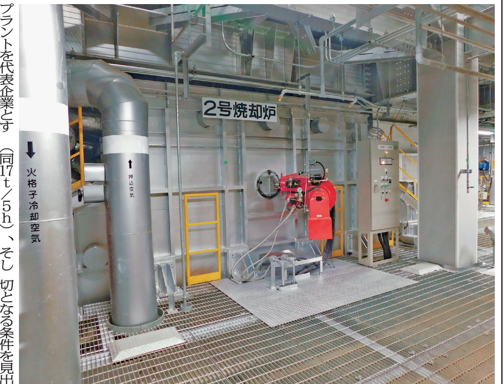
焼却炉にはエハラHPC21型ストーカシステムを導入
